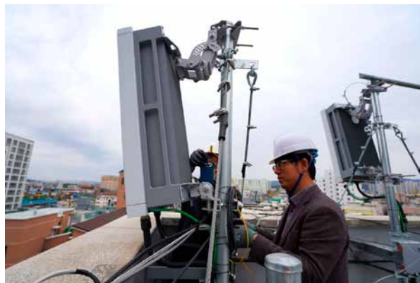
Nya enheter för 5g-radio installeras i Sydkorea.
